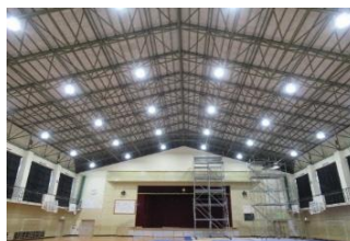
【中学校体育館へのLED照明導入】
