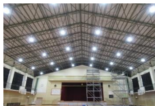
【中学校体育館へのLED照明導入】
